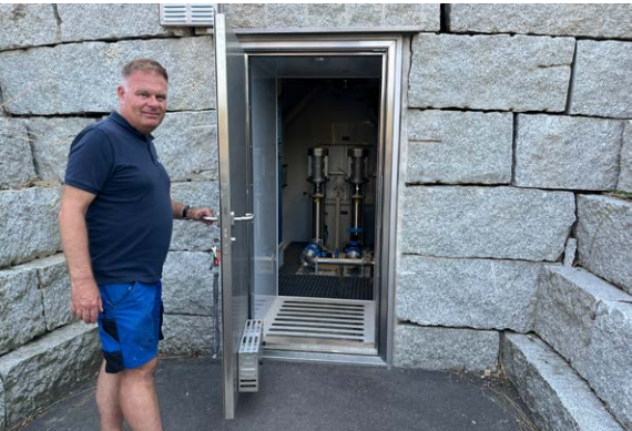
Mit Thomas Künzli im neuen Grundwasser-Pumpwerk Schachen
